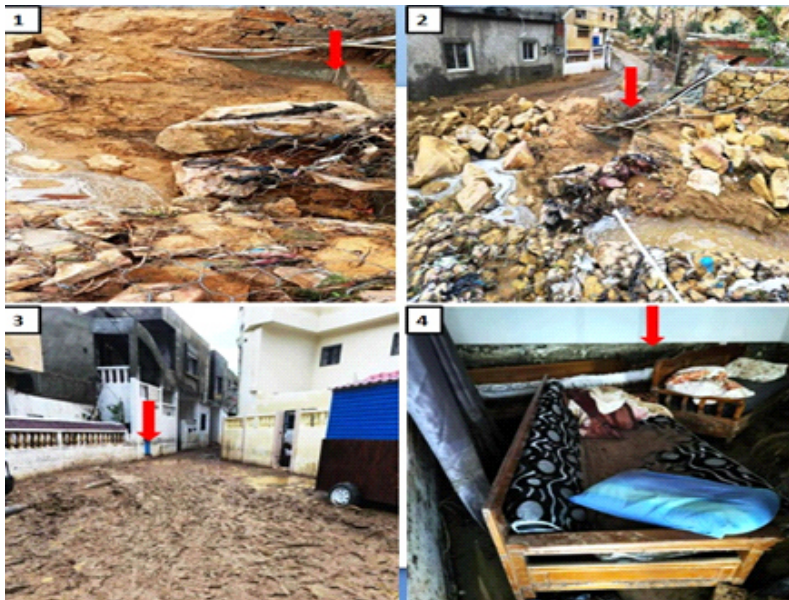
(Fig17). Cliché 1 : L'effondrement d'un mur de soutènement A Ain El Fakroun, édifié sur un conduit pluvial après la catastrophe de 2018, a été provoqué par un volume d'eau exceptionnel.
