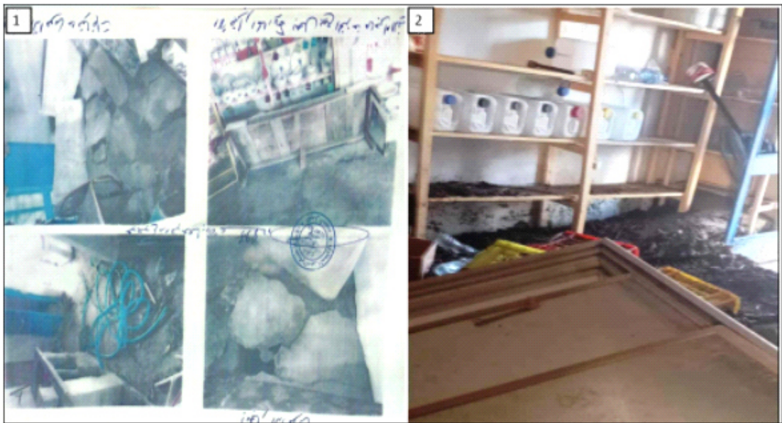
Ces clichés ont été pris dans le même endroit (Fig11). Cliché1 : L'effondrement partiel du tunnel dans un local commercial en 2018 (Cliché pris par un huissier désigné par les instances juridiques). Cliché2 : L'effondrement partiel du tunnel au même endroit en 2025(Photo personnelle)
